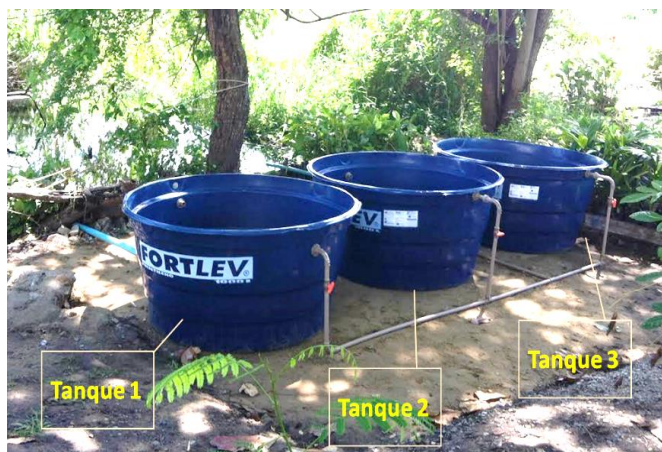
Figura 1: Sistema de tanques montado na UFCG
